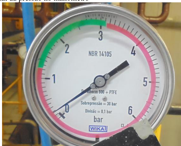
Figura 10 – Controle visual da pressão no manômetro
